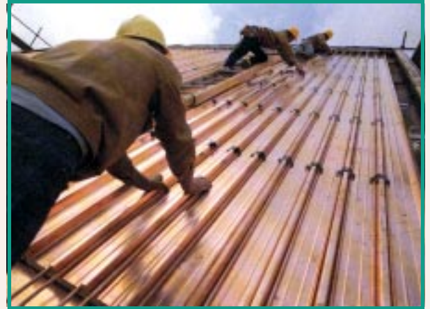
FIGURA 2.13. aprovechamiento de la energía solar en un techo
