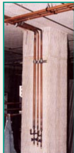
FIGURA 2.10. líneas de gases medicinales en hospital
