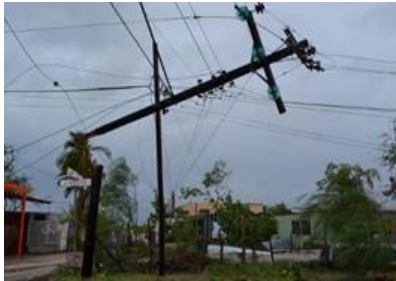
Evento climático: Huracán causa falla de energía eléctrica.
